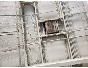
Rooftop Fan Intake Damper
