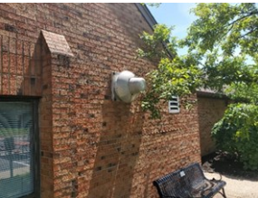
Kiln Room Exhaust Fan
