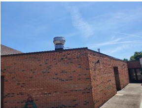
Kitchen Exhaust Fan
