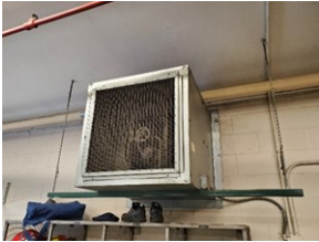
Garage Ventilation Fan
