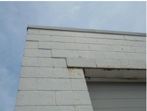
CMU cracking above bay door
