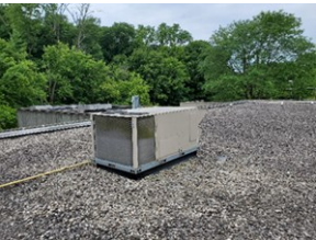
Typ. Rooftop AC Unit
